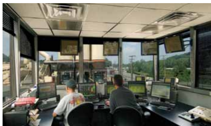
Все пульты в будках управления поставляются смонтированными и подключенными. Наклонные окна и достаточное количество подвешенного освещения обеспечивают прекрасную видимость.
