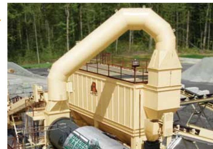
Низкая скорость ожигения предотвращает засорение системы и обеспечивает высокую производительность завода. Оператор следит за средствами управления перепадами давления.
