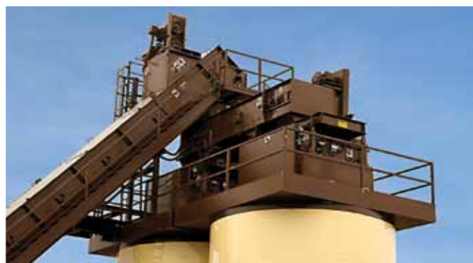
Прямоугольные платформы на верхней части силоса обеспечивают максимум рабочего пространства. Платформы, поручни, лестницы, трапы и перила устанавливаются после установки компонентов.
